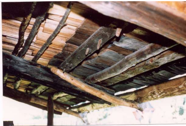
Photo 11 : la seconde rangée d'ancelles est chevillée pour mieux résister au vent en dépassée de couverture
